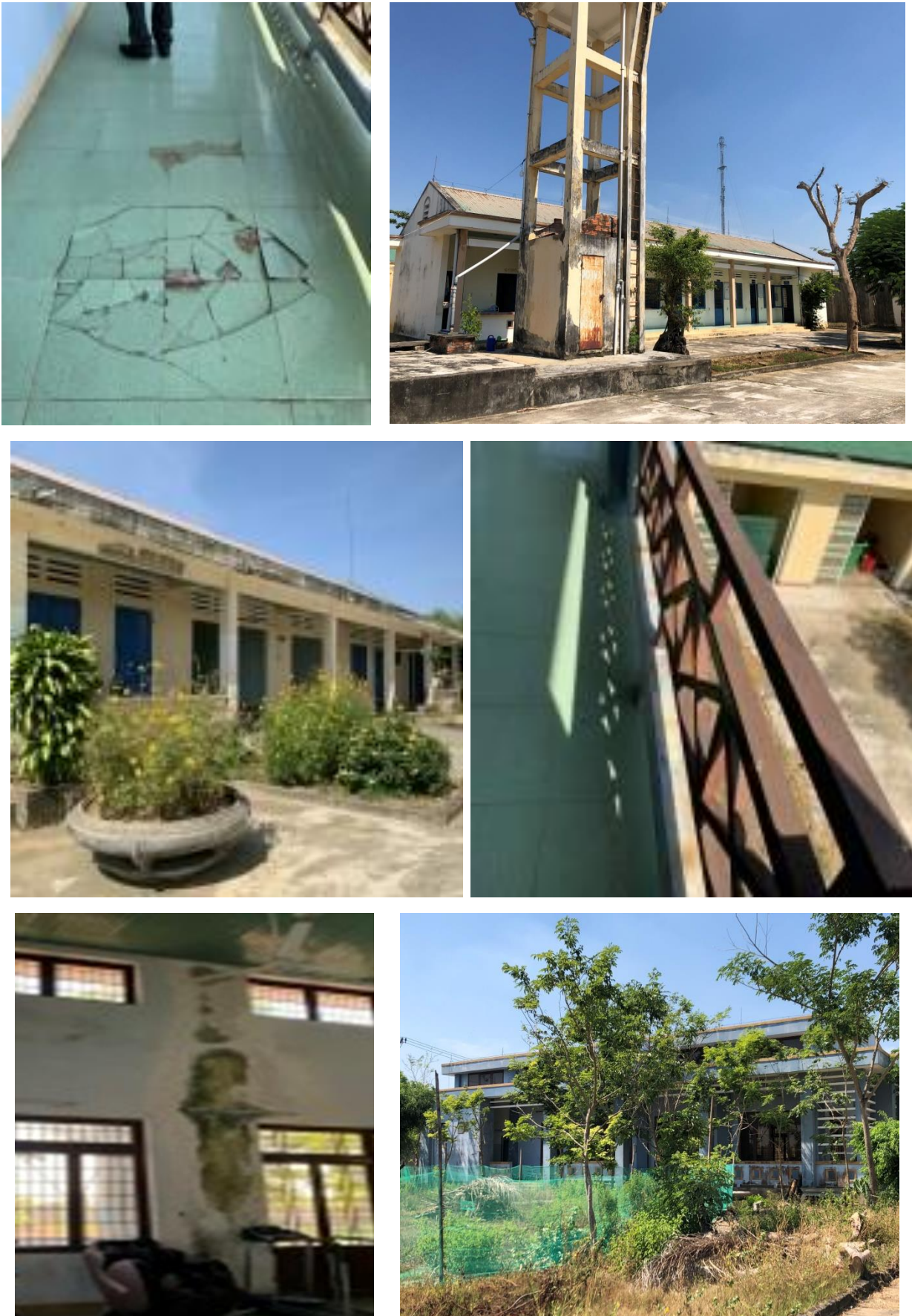
Hình 1.2. Hình ảnh hiện trạng các công trình, hạng mục xuống cấp tại Trung tâm
