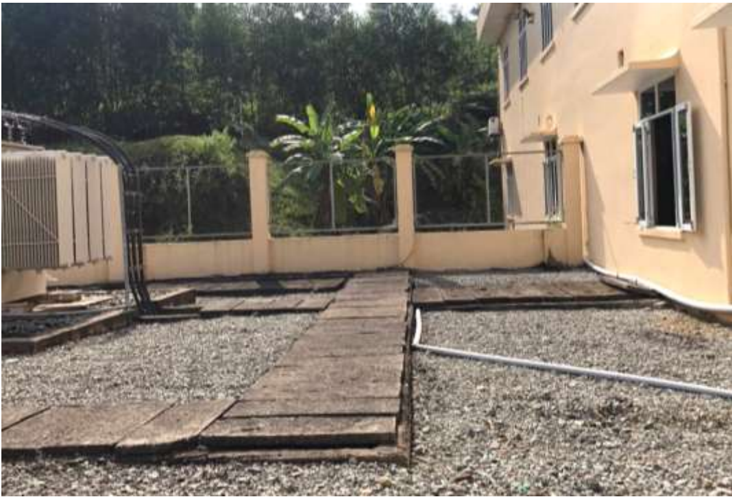
Hình 3.5. Khu vực bể chứa dầu sự cố tại Trạm biến áp
